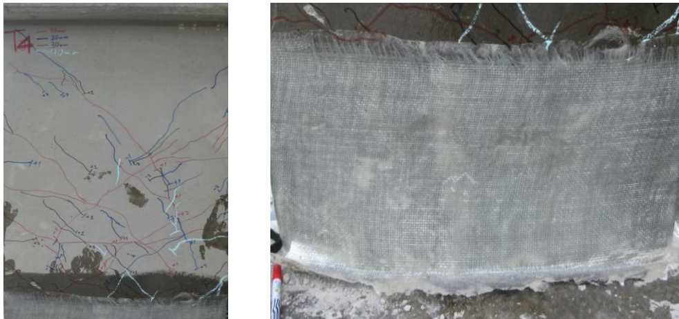
Φώτο 6. Αστοχία επισκευασμένου τοιχίου T 4 .
