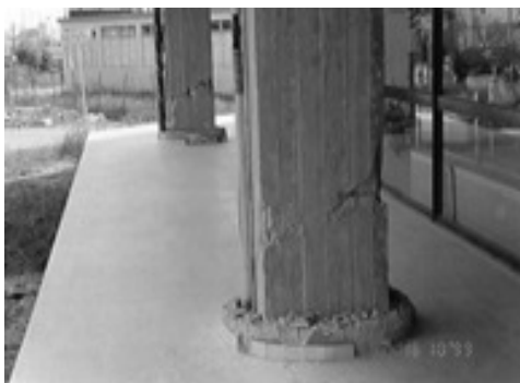
Εικόνα 4: Ρηγμάτωση υποστυλώματος λόγω κάμψης. [3]
