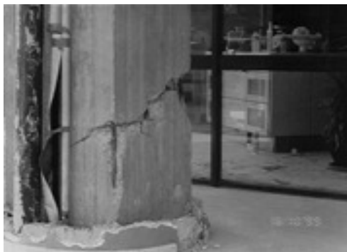
Εικόνα 5: Τοπική αποδιοργάνωση του σκυροδέματος υποστυλώματος λόγω διάτμησης. [3]
