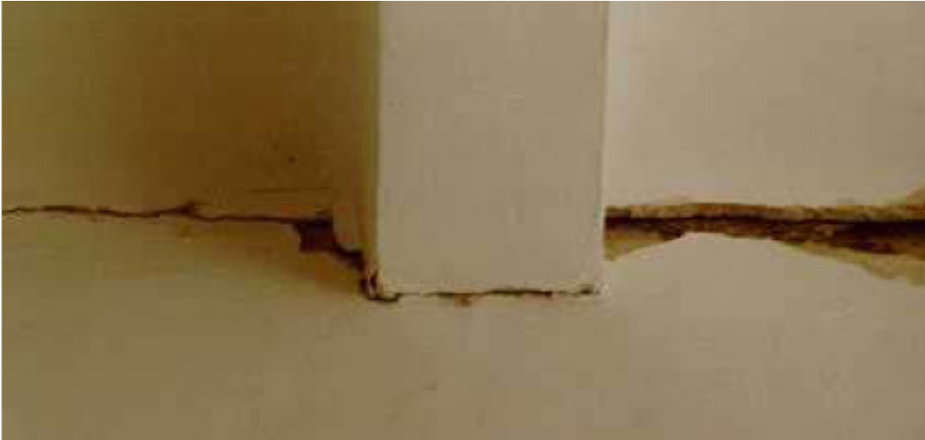
Σχήμα 9. Διαχωρισμός ξύλινου πατώματος από την τοιχοποιία. Βαθμός βλάβης : D2-D3 [1]
