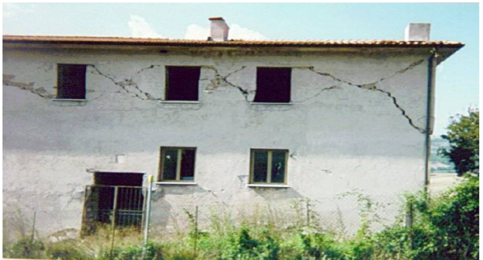
Σχήμα 10. Διαγώνιες ρωγμές μεγάλους πλάτους, Βαθμός βλάβης: D4 [1]
