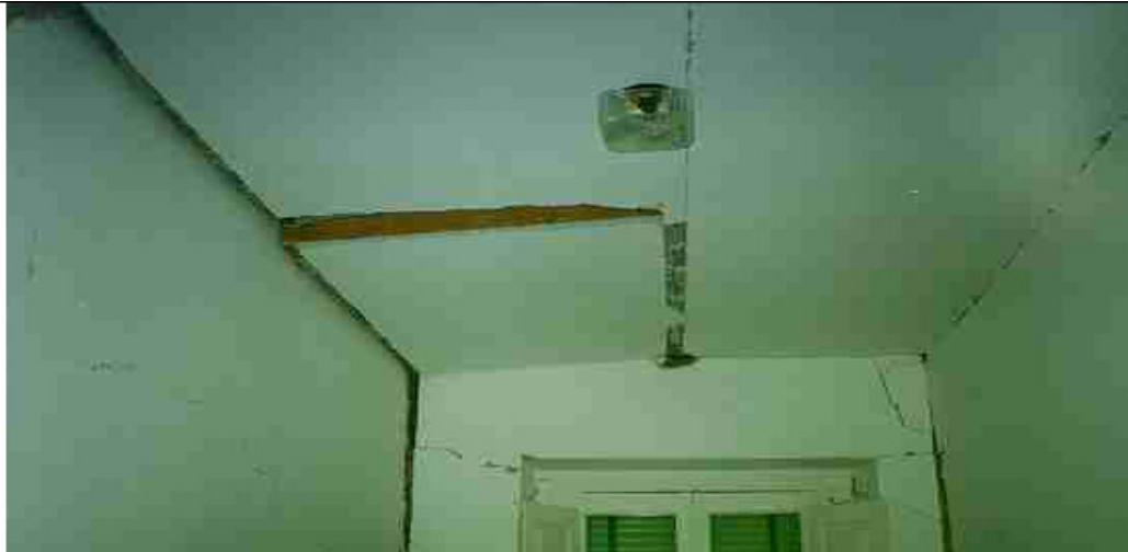
Σχήμα 11. Βλάβη στο ταβάνι λόγω διαχωρισμού τειχοποιίας και συνεπώς απώλειας στήριξης. Βαθμός βλάβης: D4 στο ταβάνι και στην τοιχοποιία [1]
