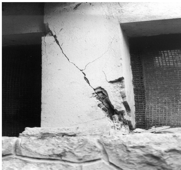
Σχήμα 12. Διαρροή λόγω διάτμησης και αξονικής δύναμης σε κοντό υποστύλωμα. Βαθμός βλάβης: D3 προς D4 [1]
