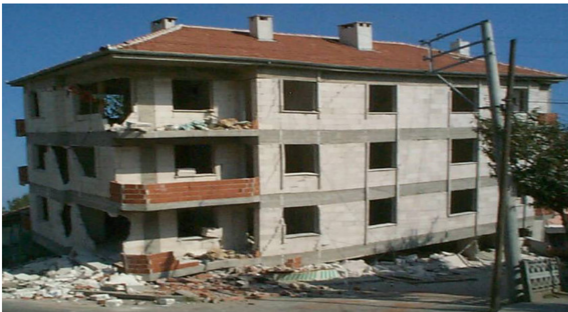
Σχήμα 13. Κατάρρευση λόγω μαλακού ορόφου στο ισόγειο. Βαθμός βλάβης: D5 [1]
