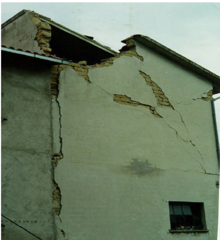
Σχήμα 8. Κατακόρυφες ρωγμές και διαχωρισμός από το διπλανό κτίριο, διαγώνιες και οριζόντιες ρωγμές στο επίπεδο του ορόφου, μερική κατάρρευση της στέγης και των τοίχων της. Βαθμός βλάβης: D2-D3 στα κατακόρυφα στοιχεία των κάτω ορόφων, D4-D5 στους πάνω ορόφους και τη σκεπή. [1]
