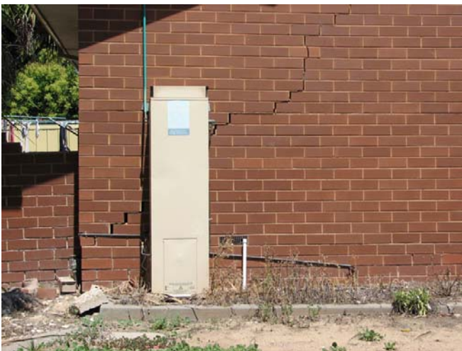
Σχήμα 1: Ρωγμή στην τοιχοποιία[3]
