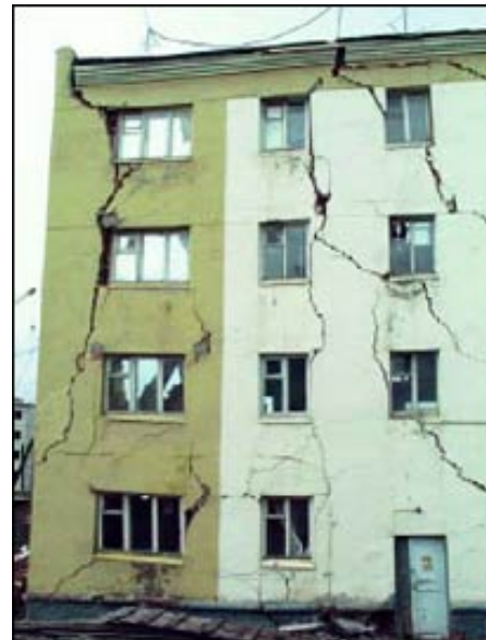
Σχήμα 2: Ρωγμές λόγω αστοχίας θεμελίου[4]
