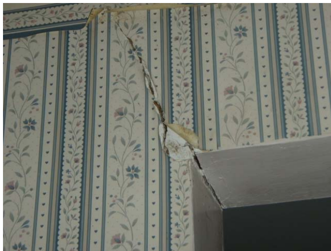
Σχήμα 4: Ρωγμή στην κάσα πόρτας[3]
