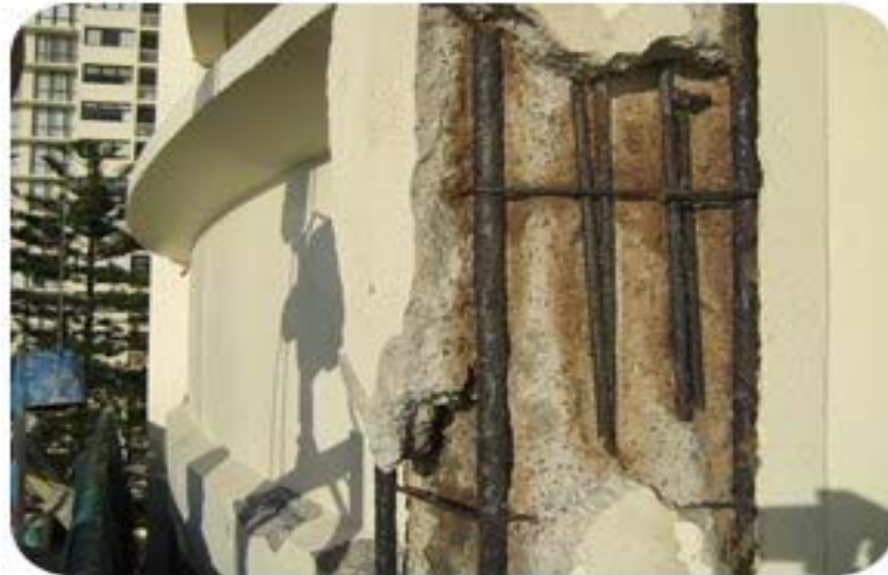
Εικόνα 3:στοιχείο που έχει υποστεί διάβρωση [2]
