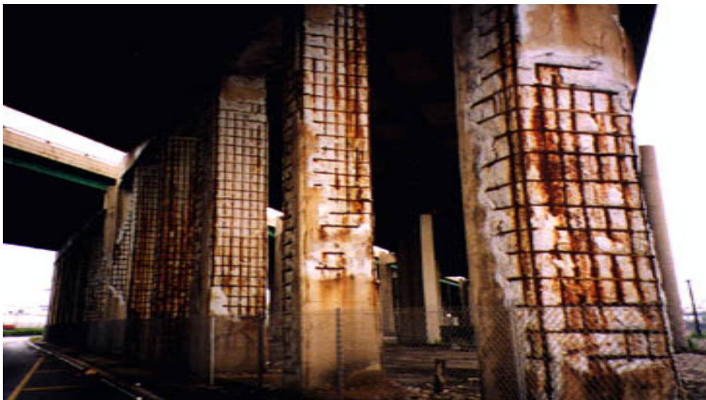
Εικόνα 6: υποστυλώματα γέφυρας που έχουν υποστεί διάβρωση [2]
