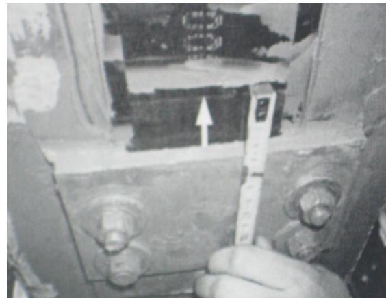
Σχήμα 3 :Αστοχία της ενίσχυσης στην περιοχή της αγκύρωσης [10]
