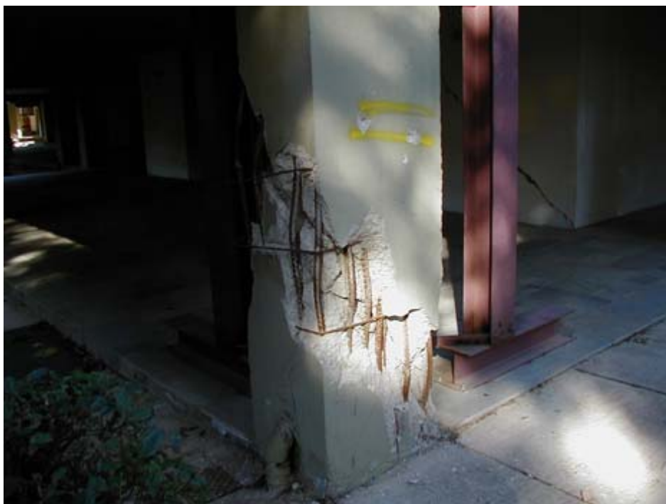
Εικόνα 1. Αστοχία γωνιακού στύλου pilotis λόγω ανεπάρκειας συνδετήρων [7]
