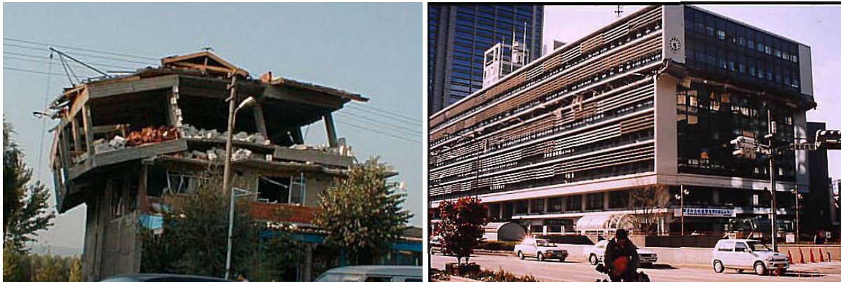
Σχήμα 2 : (α) Καταρρεύσεις ανώτερων ορόφων για καθ’ ύψος μεταβολή των διαστάσεων κάτοψης (β) Κατάρρευση ενδιάμεσου ορόφου λόγω απότομης μεταβολής κατακόρυφων στοιχείων [Φαρδής, “Αντισεισμικός σχεδιασμός κτιρίων από οπλισμένο σκυρόδεμα”]
