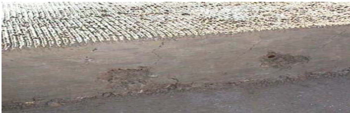
Εικόνα 2 : Ρηγμάτωση λόγω πλαστικής συστολής
