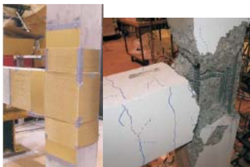
Φωτογραφίες 6,7: Ενισχυμένος κόμβος, αστοχία κόμβου χωρίς την ενίσχυση [7]
