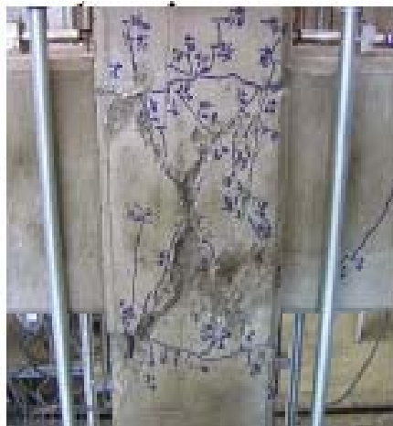
Φωτογραφία 9: Διαμητική αστοχία δοκιμίου SB-S2-U [5]
