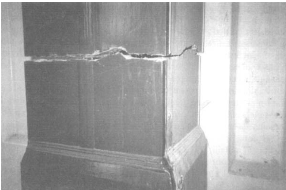
Σχήμα 10: Εφελκυστική ψαθυρή αστοχία υποστυλώματος, Ahiya-hama [30]
