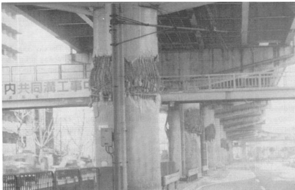
Σχήμα 11: Θλιπτική αστοχία βάθρων γέφυρας, Hanshin Expressway [30]
