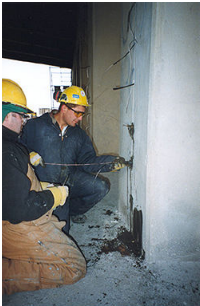
Σχήμα 3: Εγκατάσταση συστήματος ICCP [3]
