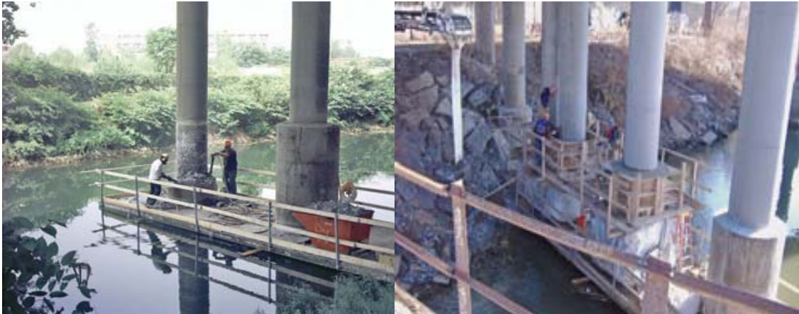
Εικόνες 12, 13 – Τμήματα από τις Scajaquada Expressway Bridges που πρέπει να προστατευθούν από το νερό του ποταμού έναντι διάβρωσης [9]
