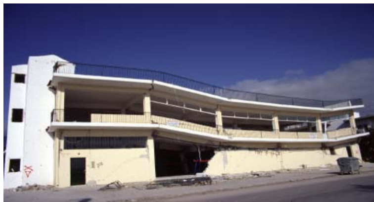
Φωτογραφία 1 αστοχία κοντών υποστυλωμάτων [2]
