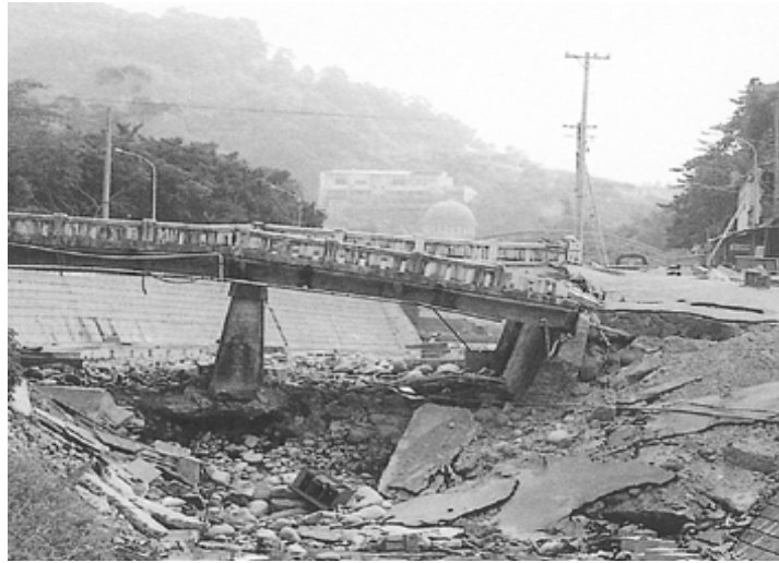
Σχήμα 4.: Αστοχία ακρόβαθρου λόγω ρευστοποίησης εδάφους θεμελίωσης.[7]
