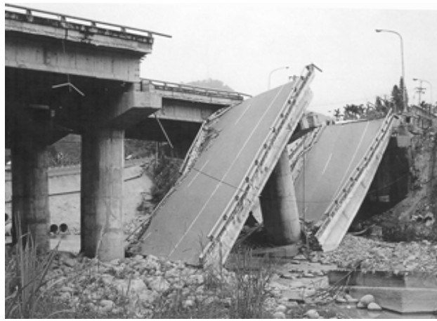
Σχήμα 1.: Αστοχία λόγω απώλειας Στήριξης [7]
