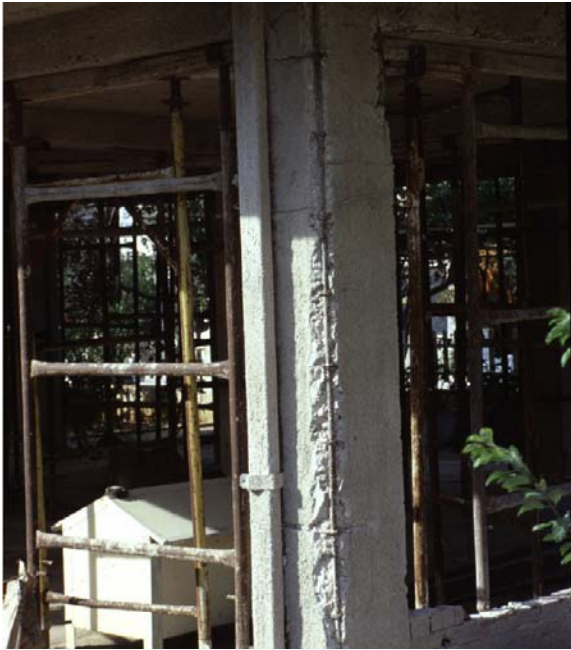
Σχήμα 2. Αποφλοίωση του σκυροδέματος της επικάλυψης [9]
