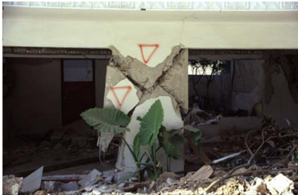
Σχήμα 5. Διατμητική αστοχία υποστυλώματος [9]
