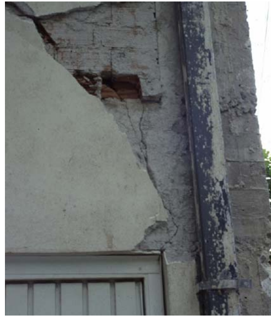
Σχήμα 3. Κατακόρυφη ρωγμή σε δοκό [9]
