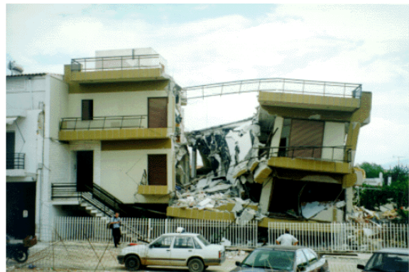
Σχήμα 6. Μερική κατάρρευση κτηρίου
