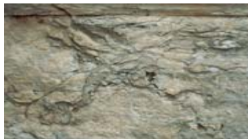
Σχήμα 14 : Αστοχία παλαιότερων επεμβάσεων συντήρησης [5].
