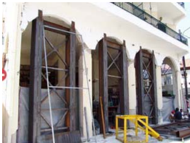
Σχημα 11 : Όψη, του παραπάνω αναφερόμενου, κτιρίου στην Λευκάδα. [4].
