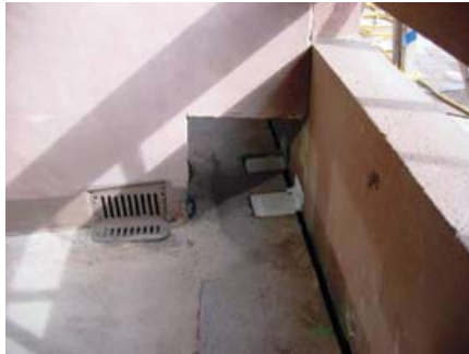
Σχήμα 9: Επισκευασμένη σύνδεση τοίχου - πλάκας. [9]
