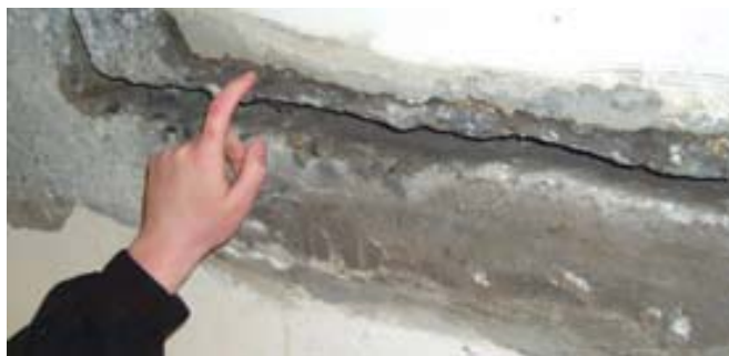
Σχήμα 6: Αφαίρεση λεπτής φλούδας υλικού κατά μήκος της ρωγμής. [10]
