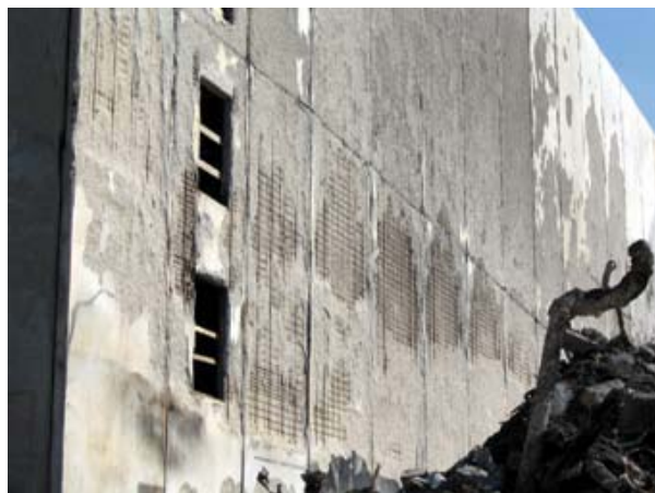
Σχήμα 14: Όψη πλευράς του γκαράζ όπου οι ζημιές ήταν σοβαρές και ορισμένα πάνελ χρειάστηκε να αντικατασταθούν. Σε αυτά τα κατεστραμμένα πάνελ πραγματοποιήθηκε έλεγχος σε μικρή κλίμακα.[14]
