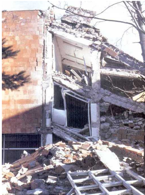
Σχήμα 22: Βλάβες σε κτίριο (1988 Spitak, Armenia Earthquake). [18]
