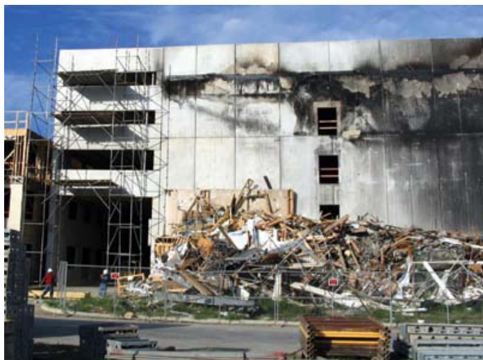
Σχήμα 13: Πάρκινγκ αυτοκινήτων σε φωτιά. [14]
