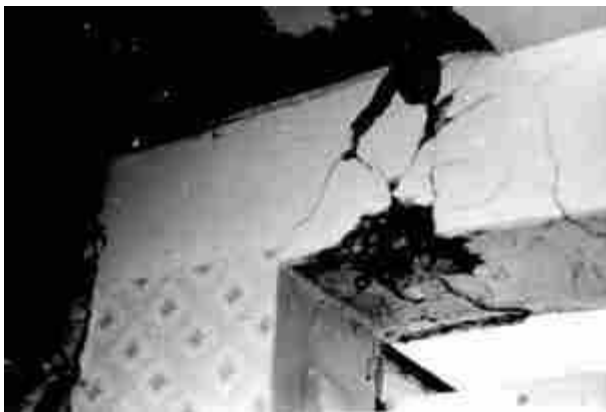
Σχήμα 19: Βλάβη κόμβου δοκού – υποστηλώματος (1988 Spitak, Armenia Earthquake). [18]
