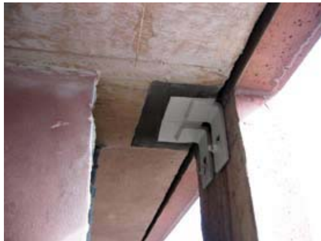
Σχήμα 10: Επισκευασμένη σύνδεση κολώνας - πλάκας μπαλκονιού. [9]
