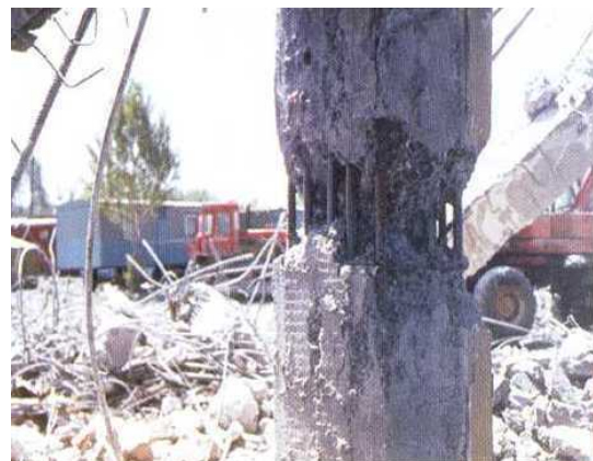
Σχήμα 20: Βλάβη σε υποστήλωμα (1988 Spitak, Armenia Earthquake). [18]
