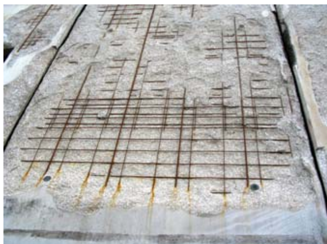
Σχήμα 15: Πάνελ τοίχου κατεστραμμένο από τη φωτιά. Η αποσάθρωση (spalling) του σκυροδέματος μέχρι βάθη 2-1/2 in. (6 cm) και πάνω, αποκαλύπτοντας τις ράβδους οπλισμού, είναι σύνηθης. [14]
