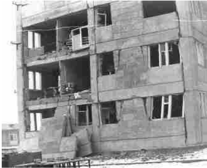
Σχήμα 21: Κατάρρευση εξωτερικού τοίχου (1988 Spitak, Armenia Earthquake). [18]
