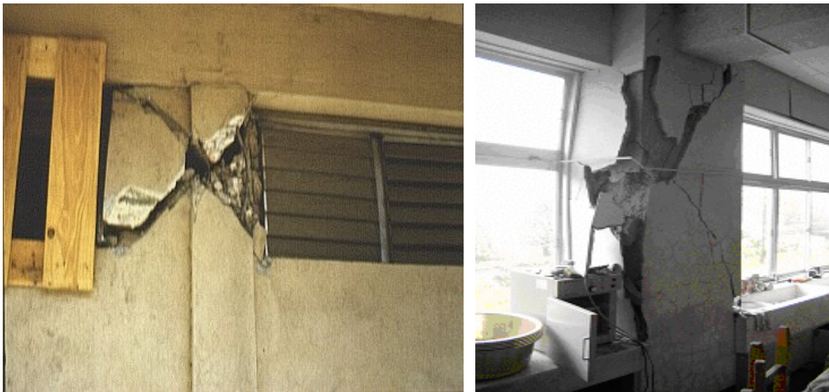
Σχήμα 5 :Αστοχία κοντού υποστυλώματος σε κατασκευές [10] , [9].
