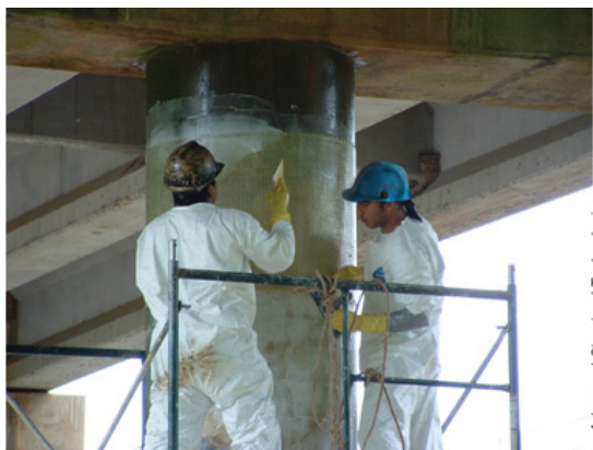
Εικόνα 5α: Εργάτες τοποθετούν δύο τμήματα περικαλύμματος ινοπλισμένου πολυμερούς από υαλονήματα σε ένα υποστύλωμα [8]
