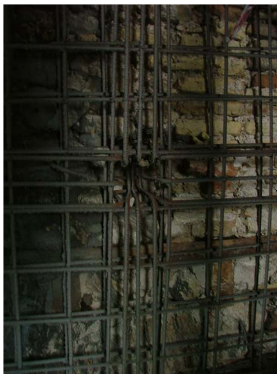
Φωτ.7: Φωλιά στη λιθοδομή.
