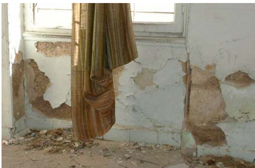
Φωτ.4: Καταστροφή των επιχρισμάτων σε ποδιά παραθύρου.
