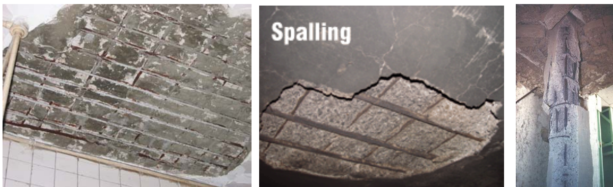
Εικόνα 1. Βλάβες δομικών στοιχείων οπλισμένου σκυροδέματος [19][15][16] .
