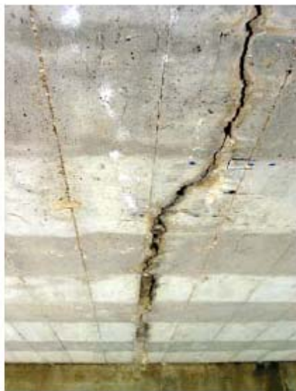
Σχήμα 11: Διαμηκής ρωγμή στην κάτω επιφάνεια του καταστρώματος της γέφυρας Martin Springs.[8]
