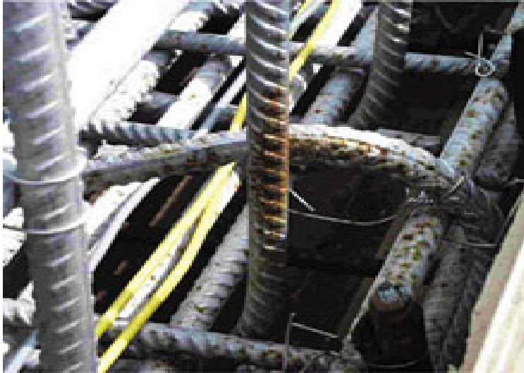
Εικόνα 4: Ανοξειδωτή ράβδος με εμφανή σκουριά μετά από επαφή με κοινό, ανθρακούχο χάλυβα και αφού αυτός έχει πλέον απομακρυνθεί. 8
