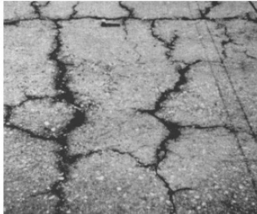
εικόνα 5. Ρηγάτωση λιμενικού δαπέδου από σκυρόδεμα λόγω διαβρωτικού περιβάλλοντος 5
