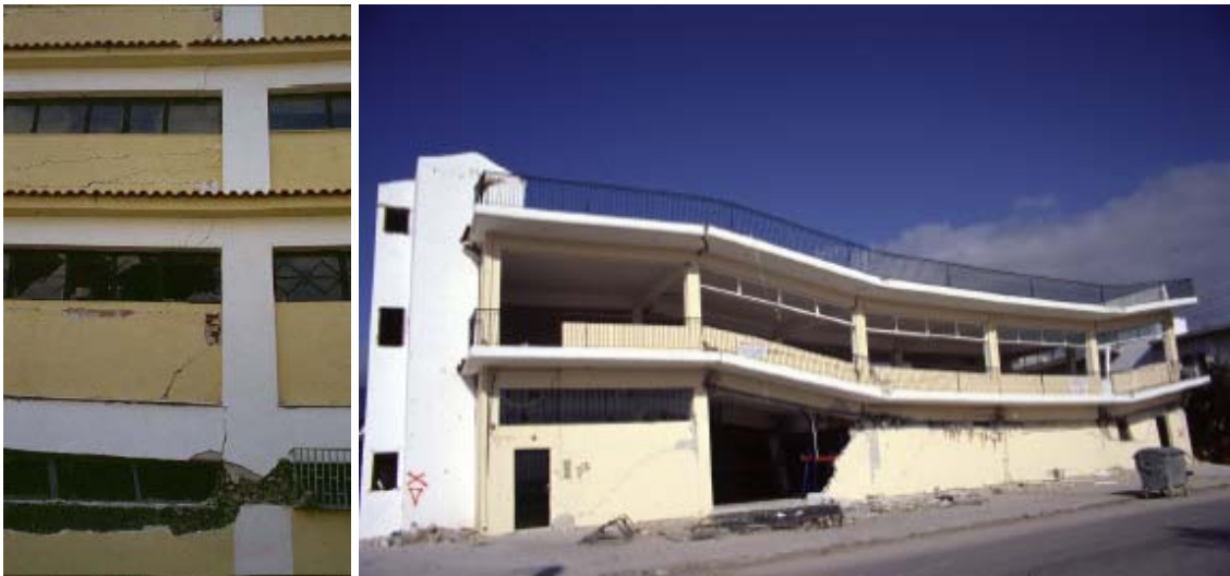
Φωτογραφία 2 - Αστοχίες κοντών υποστυλωμάτων, σεισμός Αθήνας 1999
