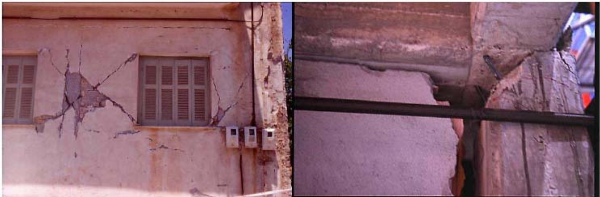
Φωτογραφία 3 - Αστοχία υποστυλωμάτων λόγω ισχυρών τοιχοπληρώσεων
