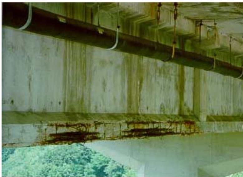
φωτογραφία 3 κατεστραμμένη δοκός στήριξης σε κατάστρομα γέφυρας[3]
