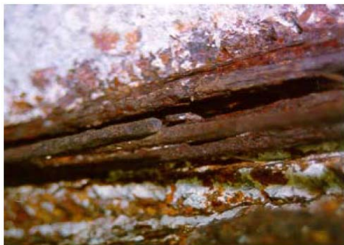
φωτογραφία 1 διαβρωμένοι τένοντες σε κατάστρωμα γέφυρας[3]
