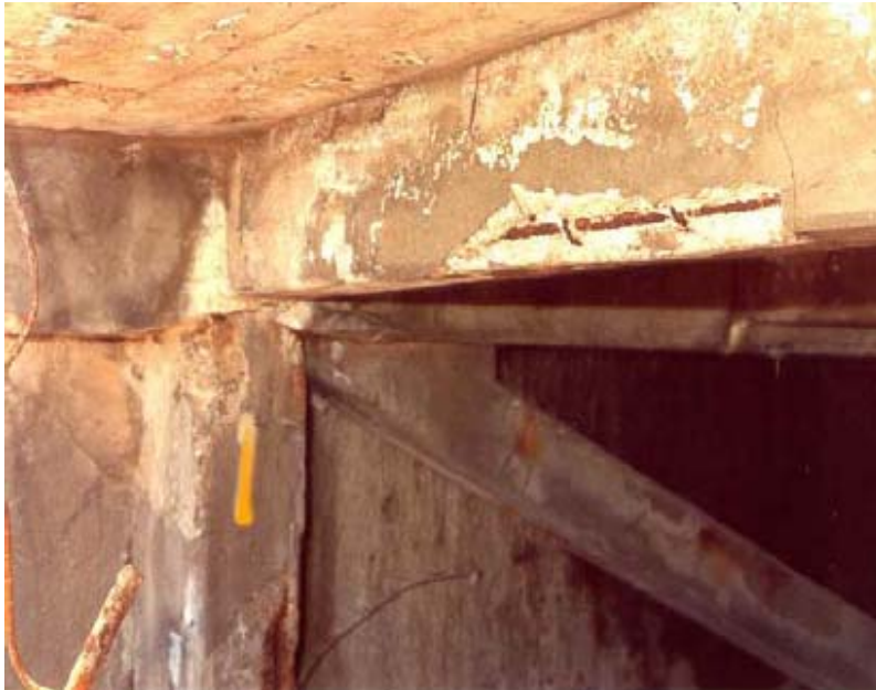
φωτογραφία 2 διάβρωση σε γέφυρα από οπλισμένο σκυρόδεμα[3]
