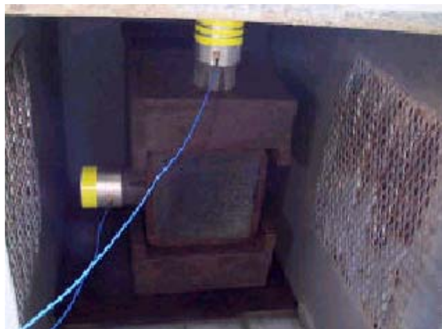
φωτογραφία 7 λεπτομέρεια δικτύου αισθητήρων σε μεταλλική γέφυρα
