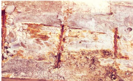
Φωτογραφία 3: Κηλίδες σκουριάς στον πυθμένα δοκού [3]
