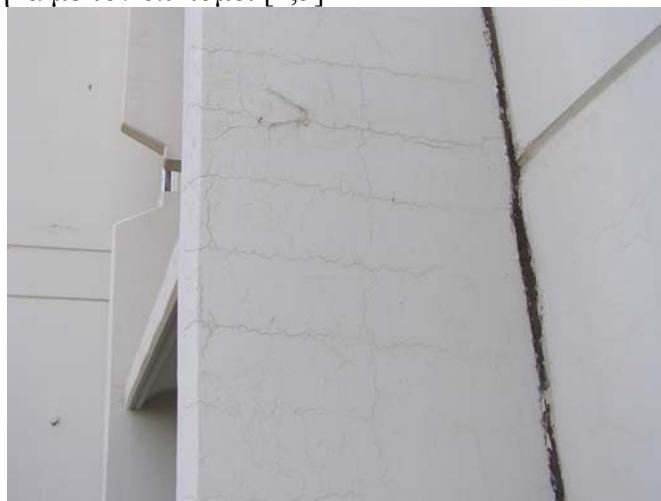
Φωτογραφία 1: Μικρορηγματώσεις σε κατακόρυφα στοιχεία κατασκευής.[9]
