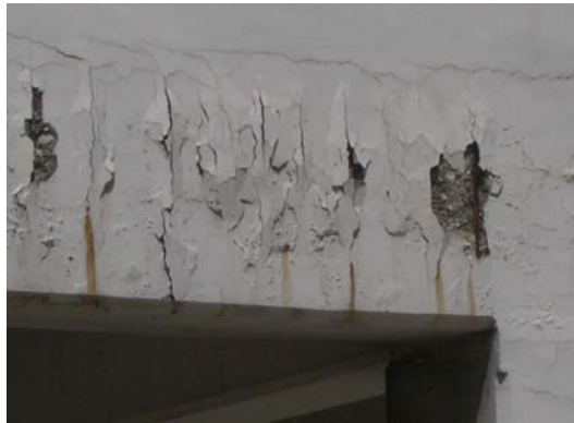
Φωτογραφία 2: Αποψη δοκού που έχει υποστεί αποφλοιώση [6]
