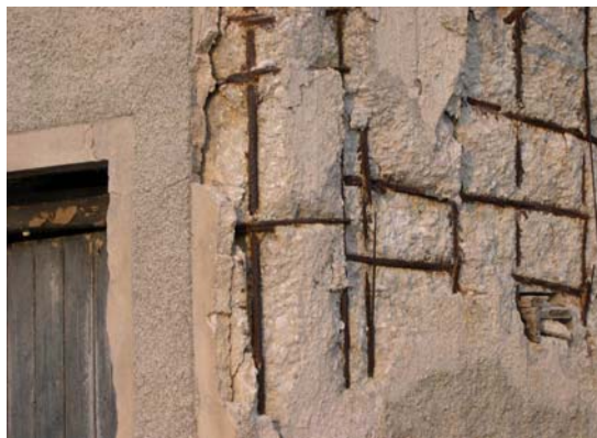
Φωτογραφία 4: Εκτίναξη της επικάλυψης λόγω διάβρωσης του χάλυβα [9]
