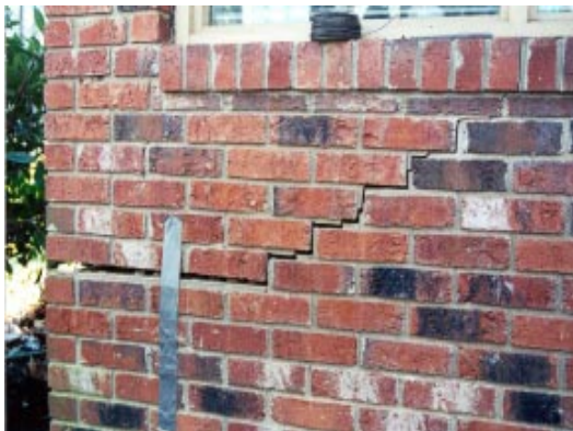
Φωτογραφία 1: Οριζόντια διαχωριστική ρωγμή σε εξωτερικό τοίχο ως ένδειξη αστοχία θεμελίου [4]
