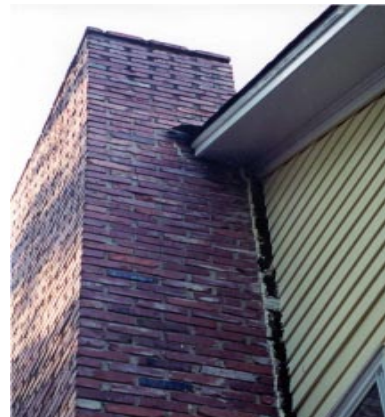
Φωτογραφία 2: Διαχωρισμός καμινάδας από τη στάθμη της στέγης [4]
