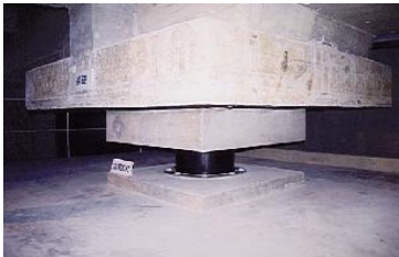
Φωτ.1 : Ελαστομεταλλικό εφεδράνο LRB.
