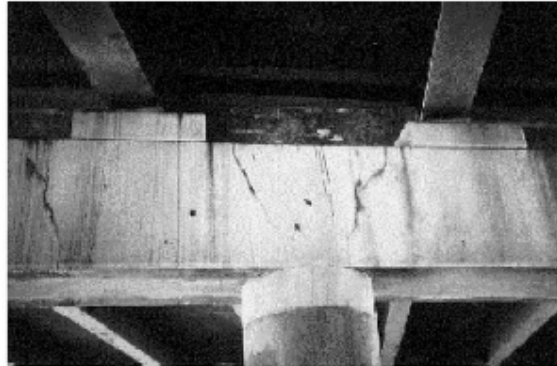
Σχ.2 Ρωγμές στο κεντρικό βάθρο.
