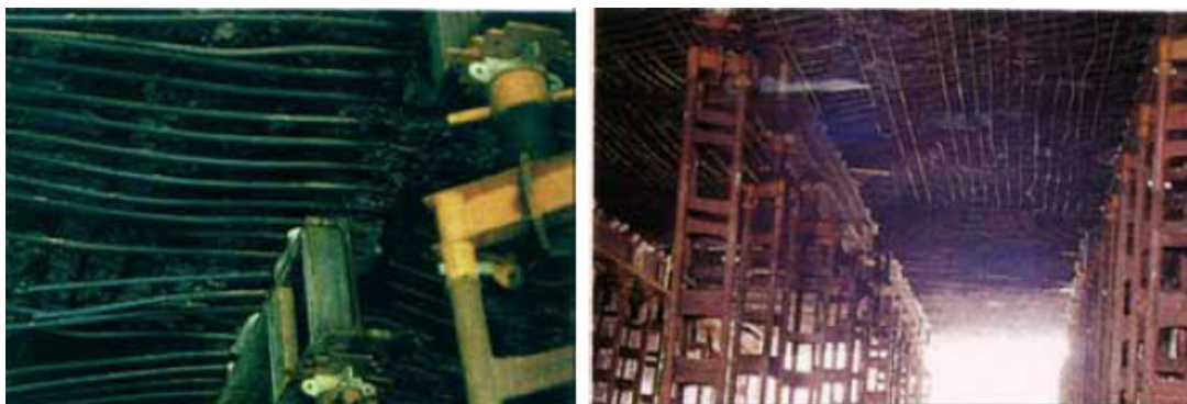
Εικόνα 24 και 25. Μέτρα προσωρινής υποστήριξης στο Summit Tunnel, σοβαρή αποκόλληση.
