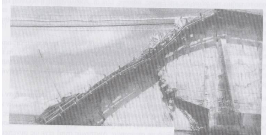
Φωτογραφία 1 : Αστοχία της γέφυρας K-B προς την πλευρά του Badeldoap.
