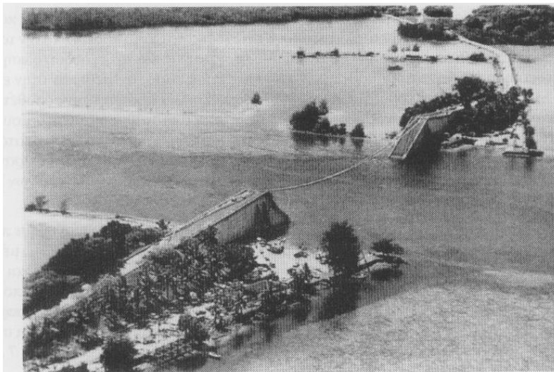
Φωτογραφία 2 : Κατάρρευση της γέφυρας Koror – Babeldoap.
