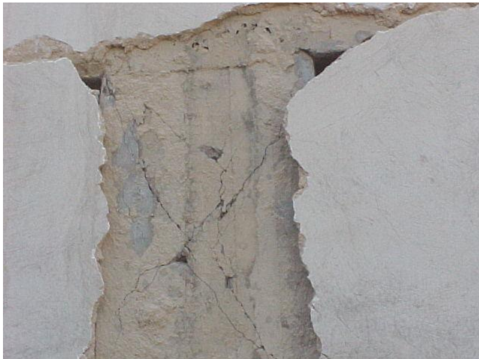
Καθαρή διατμητική αστοχία υποστυλώματος
