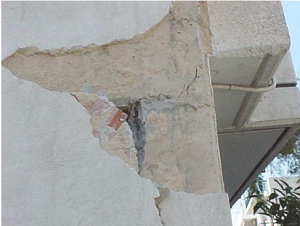
Καμπτοδιατμητική αστοχία γωνιακού υποστυλώματος
