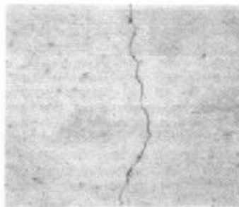
Η ανωμαλία: Ρωγμή στο σκυρόδεμα.
