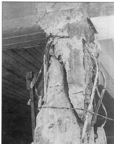
Σχ.1 : Άνοιγμα συνδετήρων και αποδιοργάνωση της κεφαλής του υποστυλώματος
