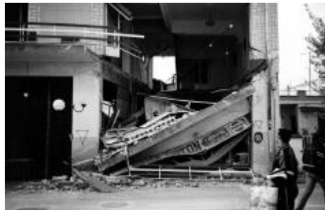
Εικ11.(Η αριστερή πλευρά της πλάκας δεν συνδέεται με οπλισμό με την υπόλοιπη κατασκευή)
