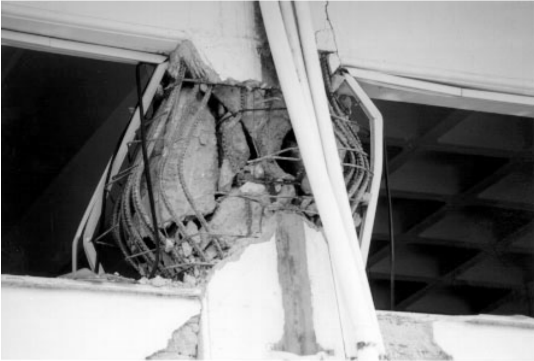
Σχ. 3 Σεισμός Αθήνας 7.9.1999. Τρόπος αστοχίας κοντού υποστηλώματος.
