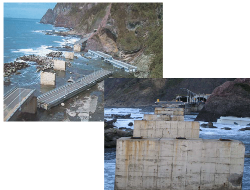
Σχήμα 6: Κατάρρευση της Omori bridge[9]
