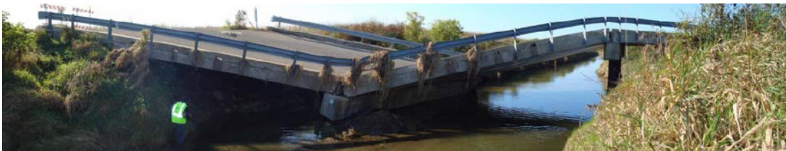
Σχήμα 10: Κατάρρευση της γέφυρας NO. SN 019-5010[13]
