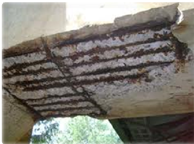
Σχήμα 1: Διαβρωμένη δοκός οπλισμένου σκυροδέματος [8]
