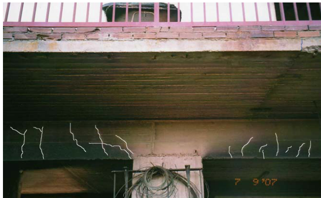
Εικόνα 11: Χαρακτηριστικές πολλαπλές καμπτικές και διατμητικές ρωγμές δοκών[11]
