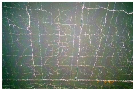
Εικόνα 12: Πλάκα οπλισμένου σκυροδέματος, χαρακτηριστικές πολλαπλές ρωγμές [11]
