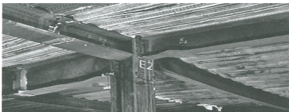
Σχήμα 9: Όψη της κατασκευής μετά από το πείραμα 3 [6]
